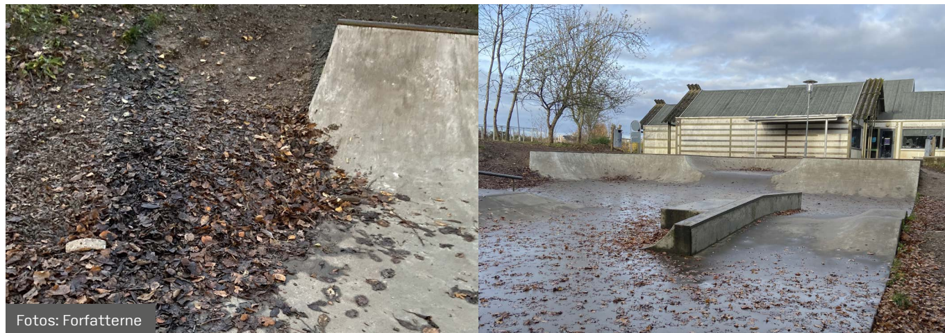
Foto 20 og 21: Nedfald og flis i parken.
